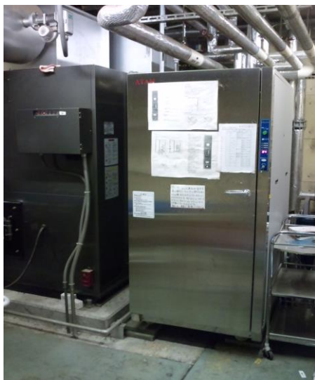
長野県内 介護老人保健施設 (ボイラー室内)
