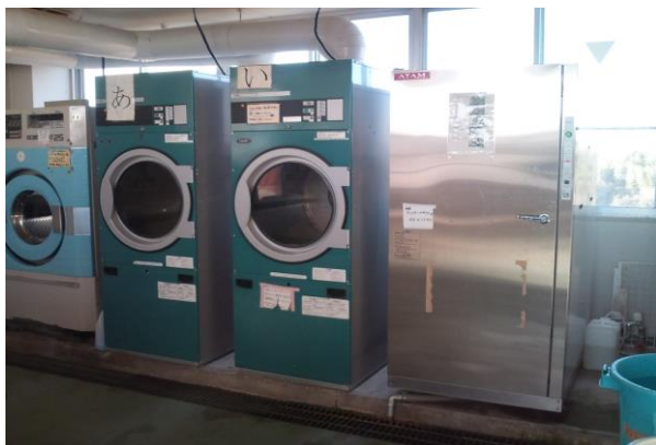
愛知県内 特別養護老人ホーム (洗濯室内)
